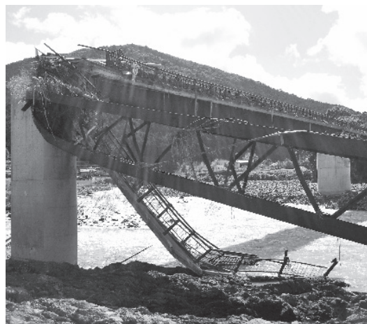
土石流で壊されたと考えられる皆瀬橋
