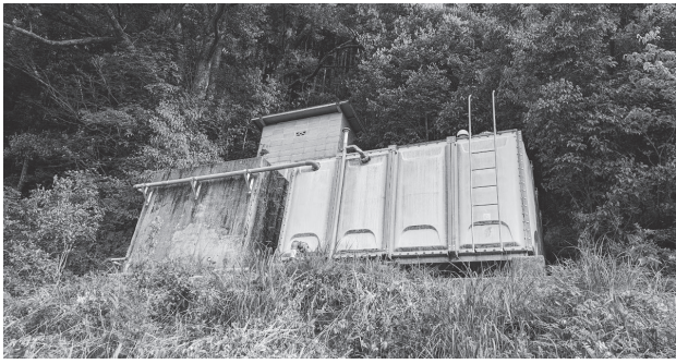
富里平瀬集落水道のタンク
